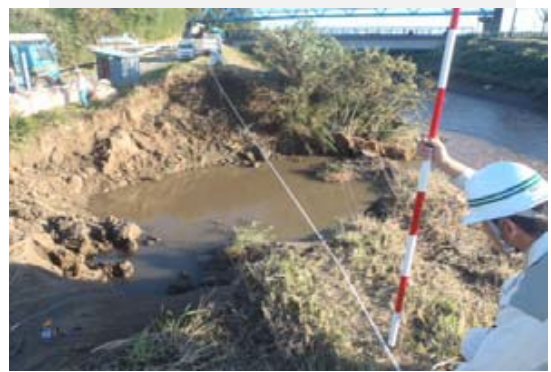
砂押川の破堤状況
