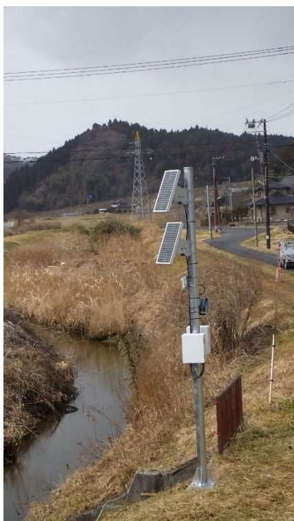
監視カメラ 設置状況（新川）
