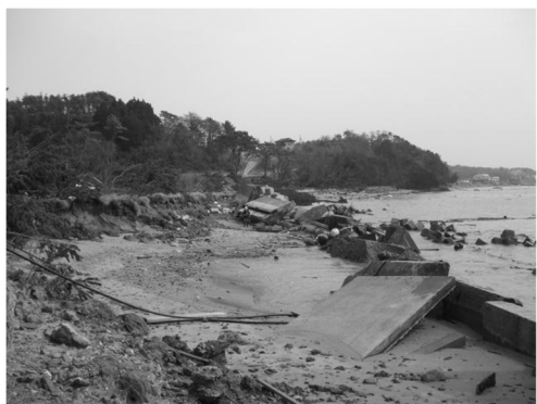
写真-4 海岸防潮堤の被害
