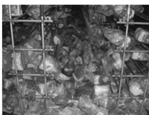
写真-5 きのこ生産施設の被害
