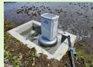
導入した自動給水栓 (尾袋川東地区)
