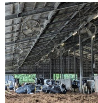
畜舎環境制御装置
