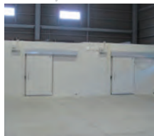
▲冷凍・冷蔵庫
