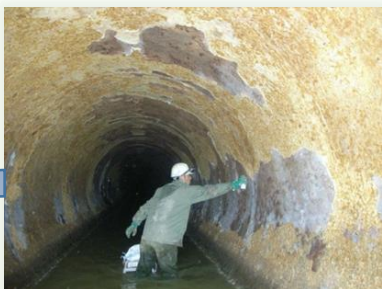
劣化した下水道管
