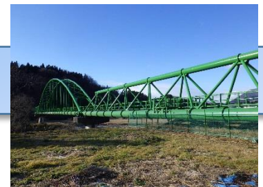
水道管 (送水管)
