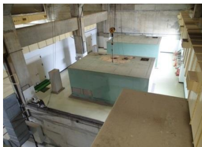
老朽化した脱水機
