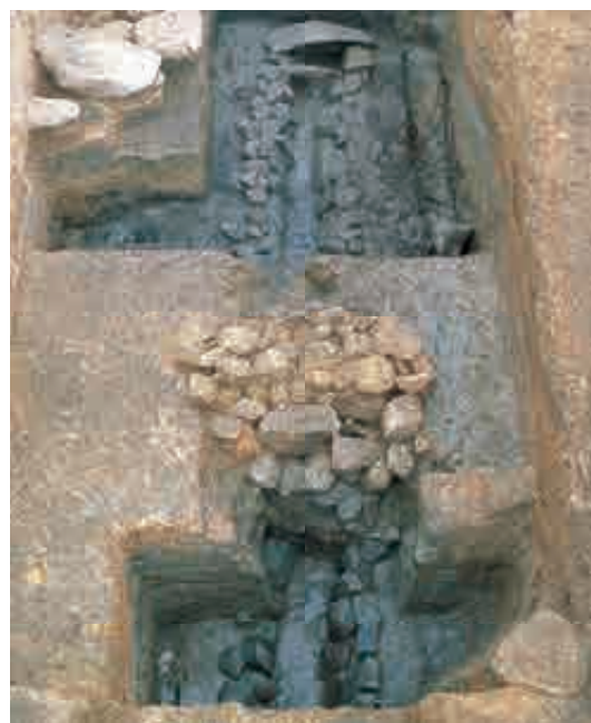
道路につくられた暗渠排水施設 政庁南大路の東側の丘陵から西側の低湿地へ排水するために道路下に設けられたⅠ期の暗渠と集水樹。
