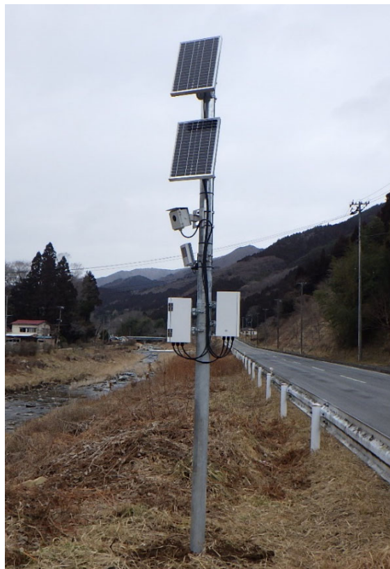
監視カメラ 設置状況(津谷川)
