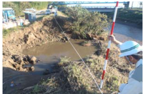
砂押川の破堤状況
