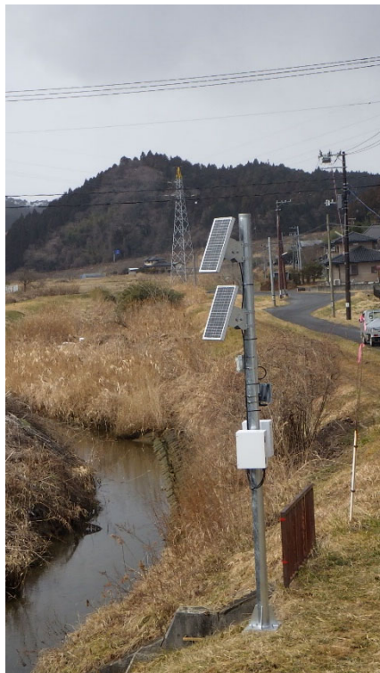
監視カメラ 設置状況（新川）
