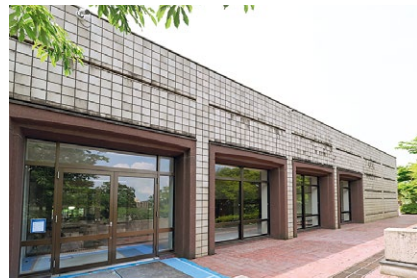
汚れが目立つ外壁（北側）
