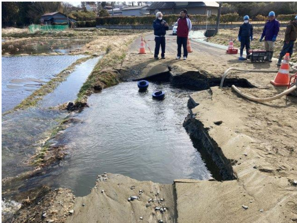
令和4年3月16日地震（松山第2受水池付近の漏水）
