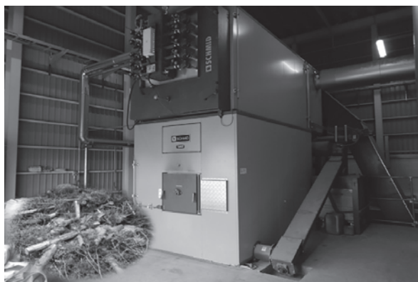
▲木質バイオマスボイラー
