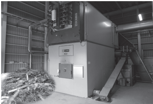
▲木質バイオマスボイラー
