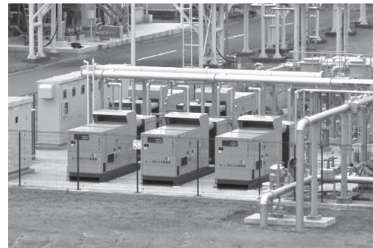
▲仙塩浄化センター消化ガス発電所
