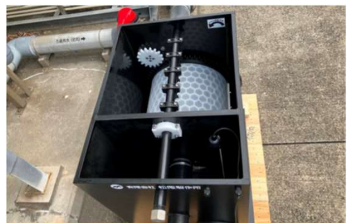
自動で物理濾過を行う設備もある (ドラムフィルター)
