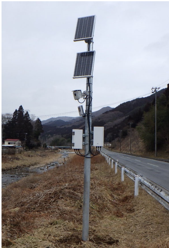
監視カメラ 設置状況(津谷川)
