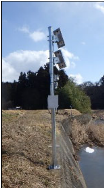
監視カメラ 設置状況（七北田川）
