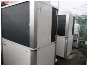
高効率空調機（室外機）
