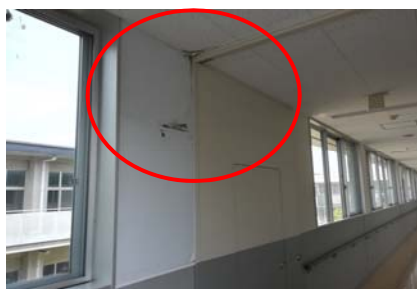
2階の管理棟との渡り廊下部分の 天井材と壁材
