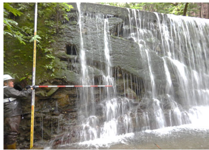
コンクリート堰堤の要対策箇所
