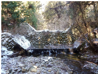
石積堰堤の要対策箇所
