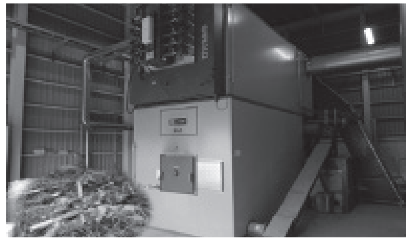
▲木質バイオマスボイラー
