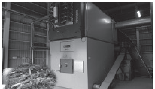
▲木質バイオマスボイラー
