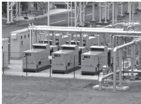
▲仙塩浄化センター消化ガス発電所
