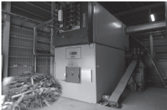
▲木質バイオマスボイラー
