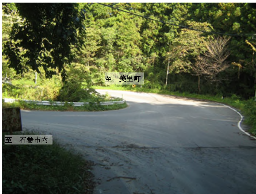
線形不良箇所
