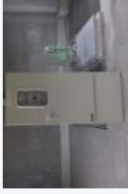
中峰：急速攪拌機（制御盤）
