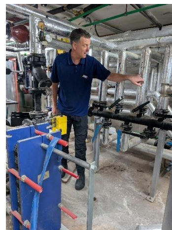
熱交換器と配水パイプ
