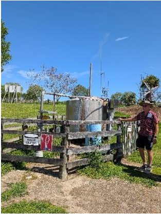
地熱温水汲み上げ設備
