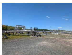
地熱生産井と配水パイプ
