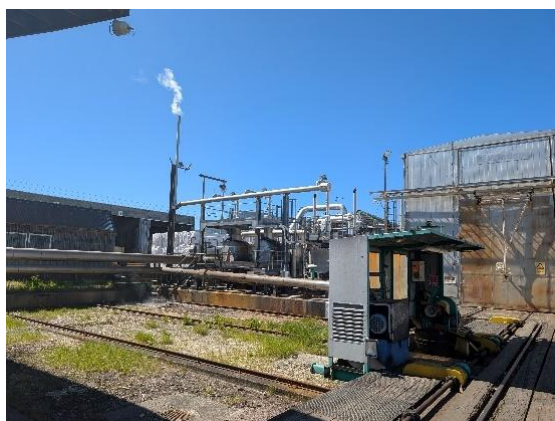
熱交換器と配水パイプ
