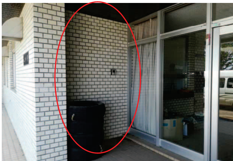
タイルの大きな浮き。
