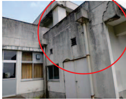
外壁モルタルの劣化。
