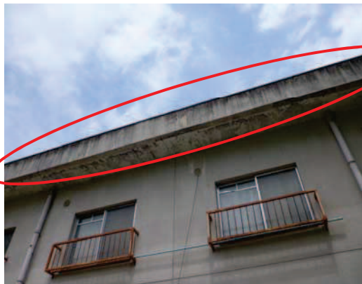
パラペット外壁側のモルタルの劣化。 軒天も劣化しています。
