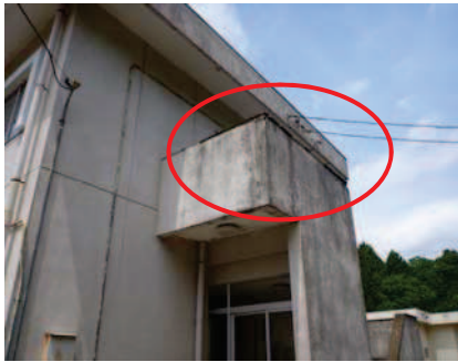
階段部分の笠木モルタルの劣化。
