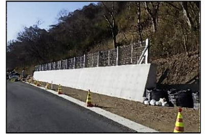
【(一)北上河北線・中野（道路災害復旧）】
