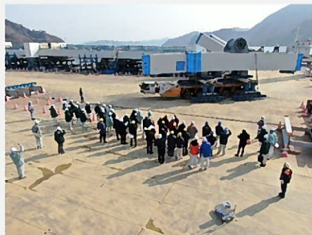
【出島架橋本体工事 現場見学会】 研修内容： 海上輸送台船からの水切り状況 地組立て状況
