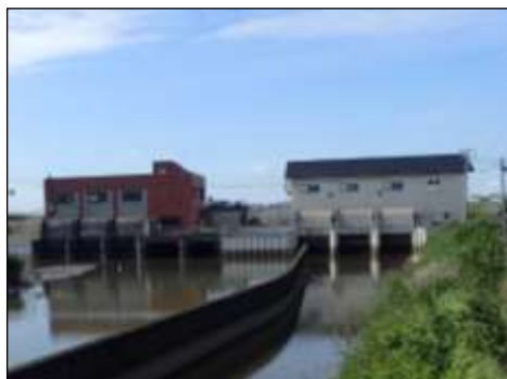
洪水から農地を守る五ヶ村堀排水機場
