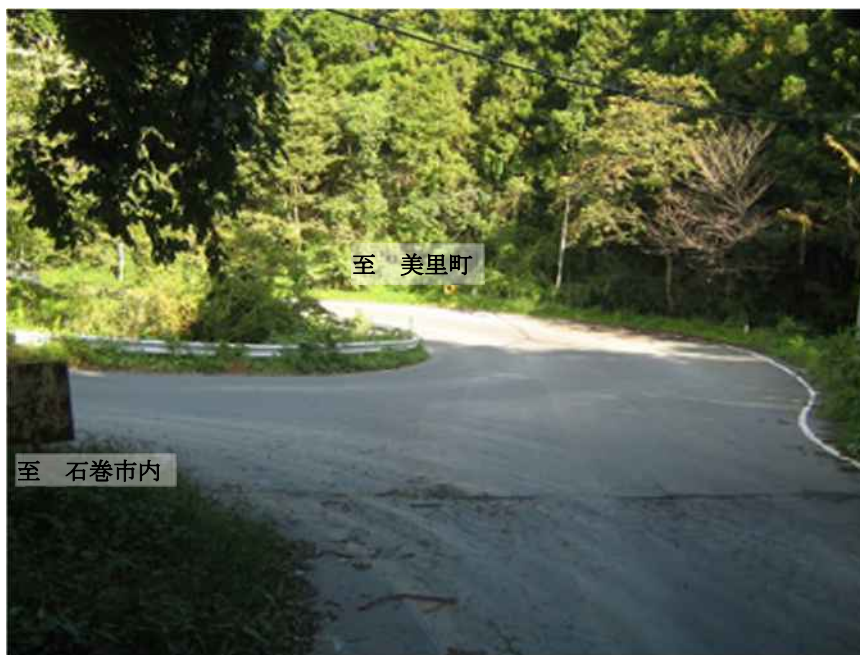
線形不良箇所
