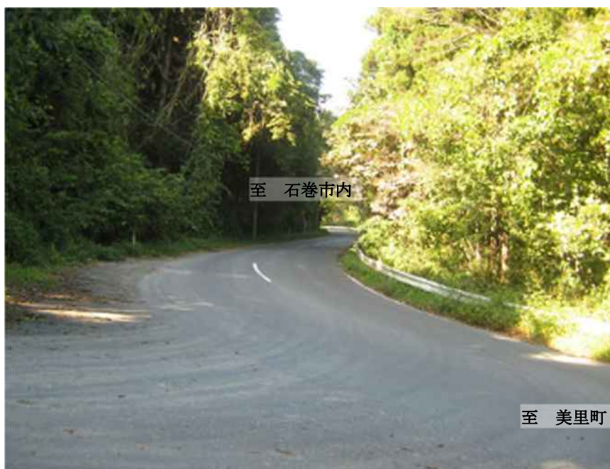
線形不良箇所
