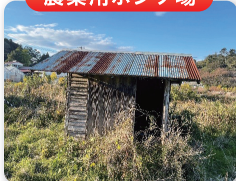
農業用ポンプ場
