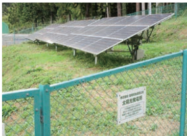
設置している太陽光パネル
