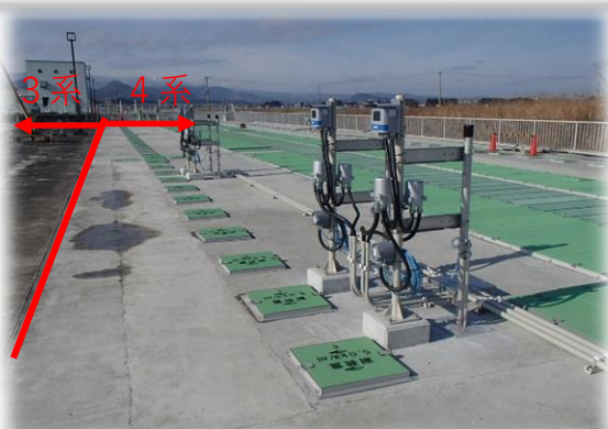
新設した計装設備（DO計など） （4系列反応タンク）
