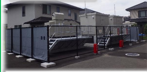
浸水想定高以上に高上げ更新した非常用発電設備 （写真左が発電機、右が燃料油庫）
