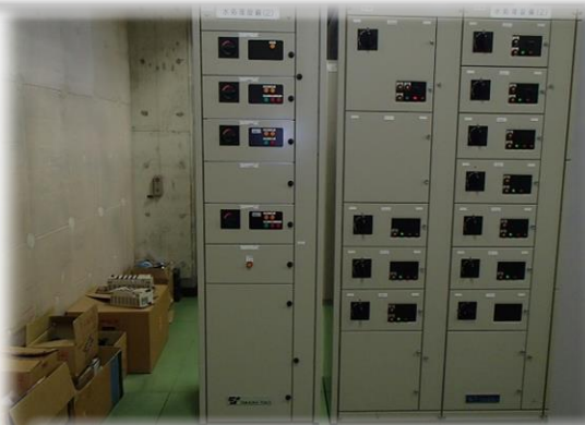
新設したコントロールセンタ （送風機棟電気室）
