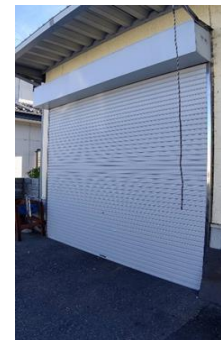
シャッター設備
