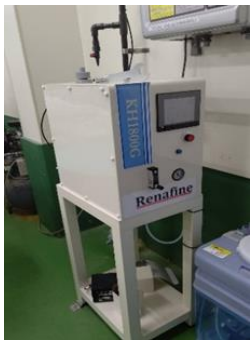
pH調整次亜 塩素酸水設備
