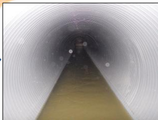
下水道管 (流域下水道管渠)
