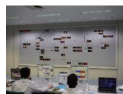
流量・水圧等の監視 (24時間・365日)
