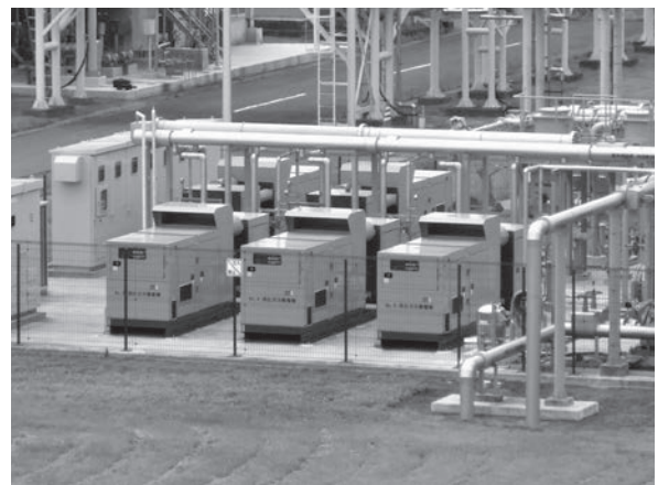
▲仙塩浄化センター消化ガス発電所
