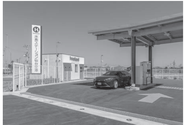
▲県内2基目の商用水素ステーション（イワタニ水素ステーション仙台空港）
