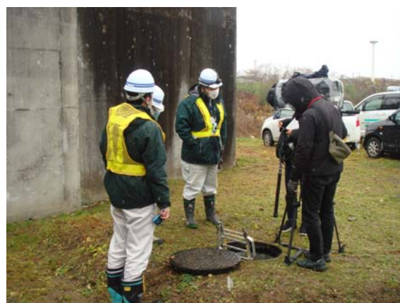
マンホール内バルブ確認（TV取材）
