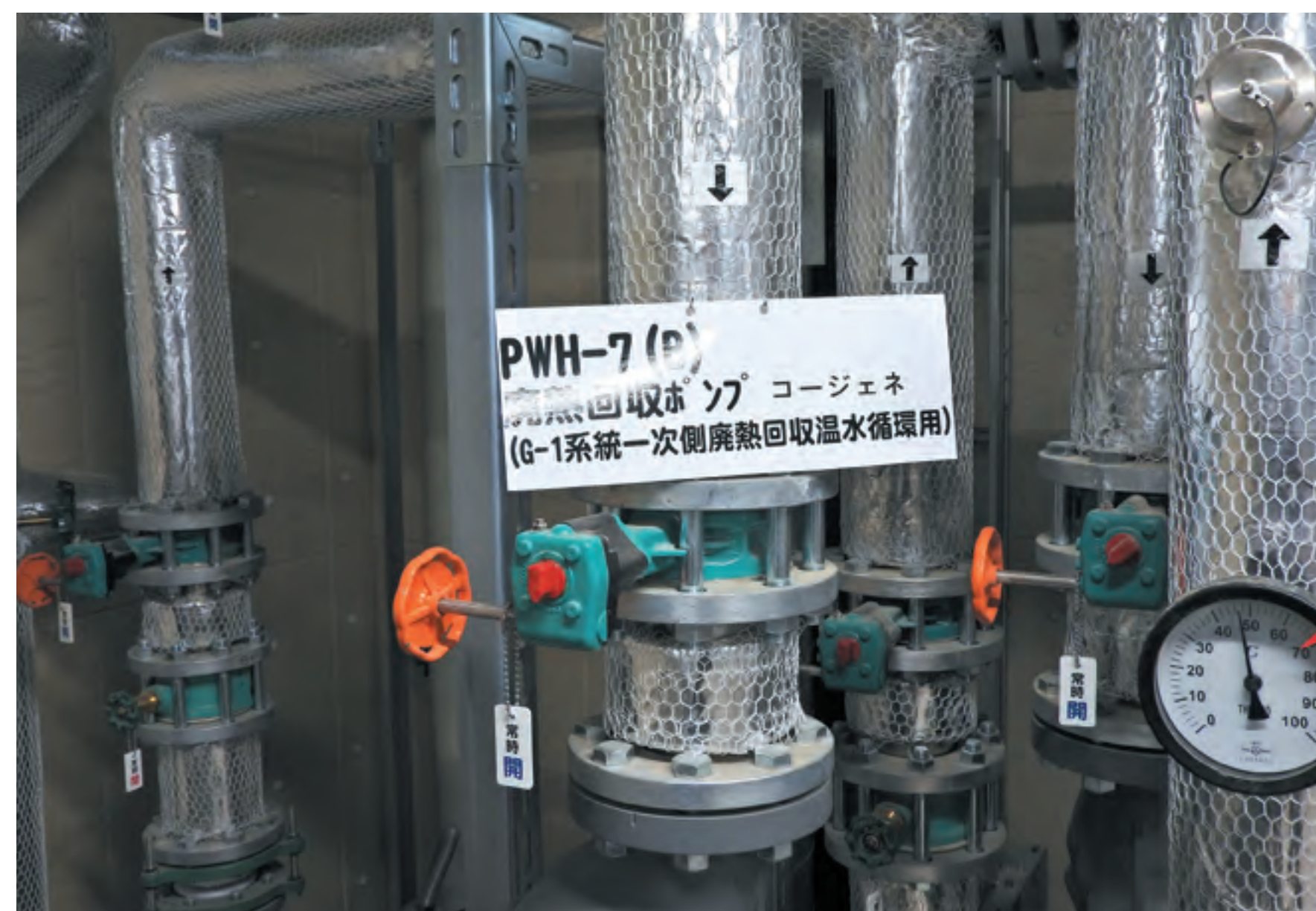
廃熱回収ポンプ
