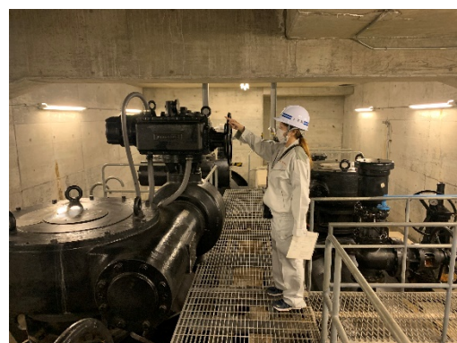
流入弁室（小村崎制御室）
