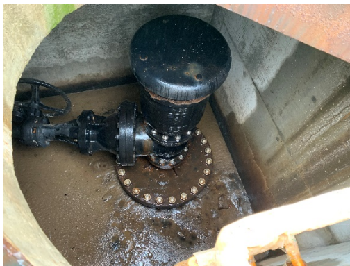
マンホール内の空気弁
