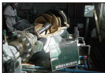
不來内排水機場全景(左)とポンプ整備状況(右)(不來内地区)
