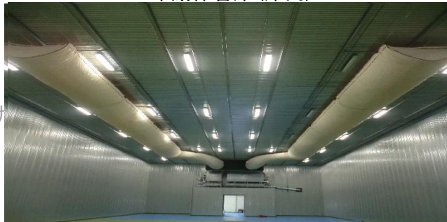
冷蔵保管庫(庫内)
