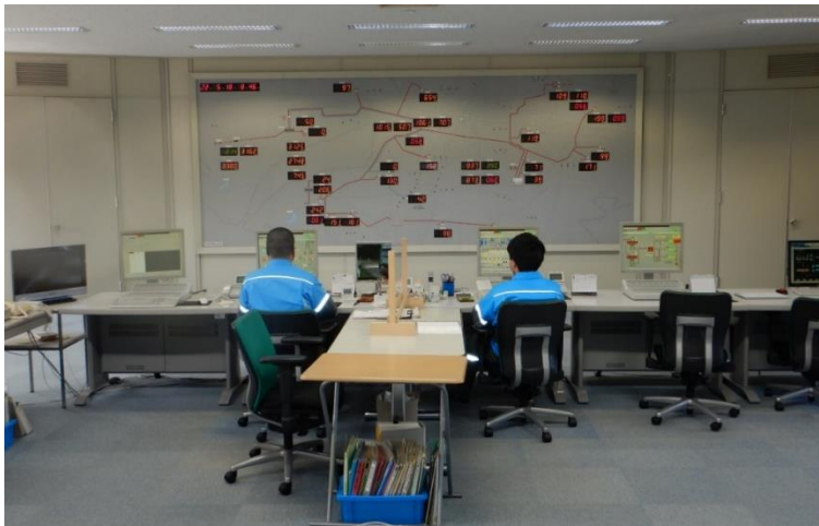
中央監視室における 施設運転状況の監視
