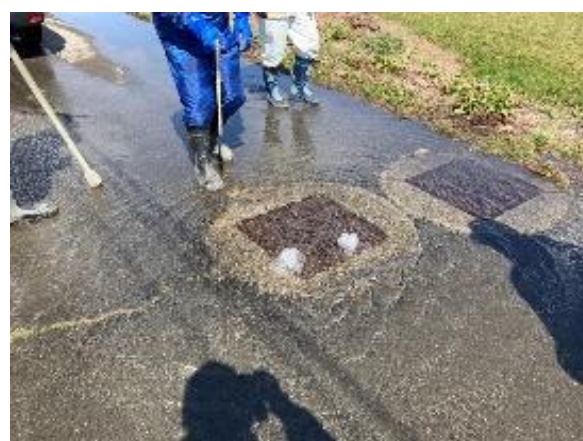
大崎市鹿島台青生水管橋付近 空気弁漏水状況
