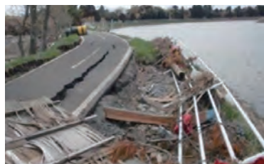
■被災時 沈下戻し区間流部 堤防盛土状況
