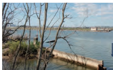
■被災時 L1堤防区間 定川大橋上流部
