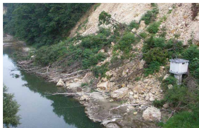
▲白沢河川水位観測所 復旧前 崖の崩落により観測所の機能停止
