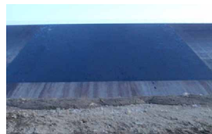
▲南川鞍部ダム 復旧完了 遮水性密粒度AS及び表面保護層を設置
