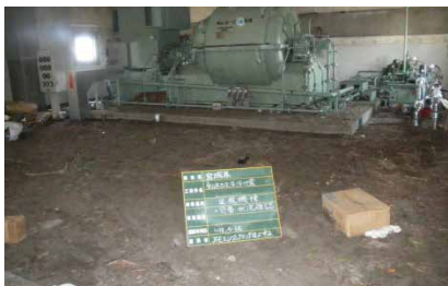
▲送風機設備被災後 ガレキ・土砂堆積状況
