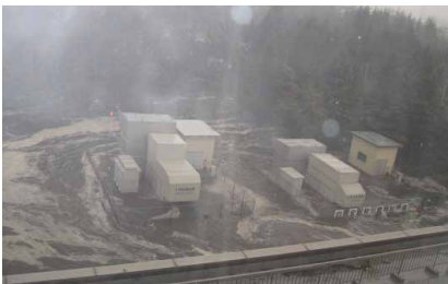
▲自家用発電機 津波による浸水状況
