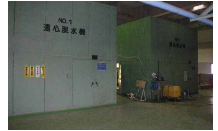
▲復旧した自家発電設備
