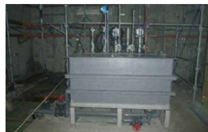
▲流入水質測定装置設置状況
