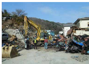
浮き桟橋が乗り上げ国道を寸断(石巻市 国道398号 内海橋)
