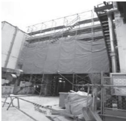
写真 地震による被害を受けた施設の様子
