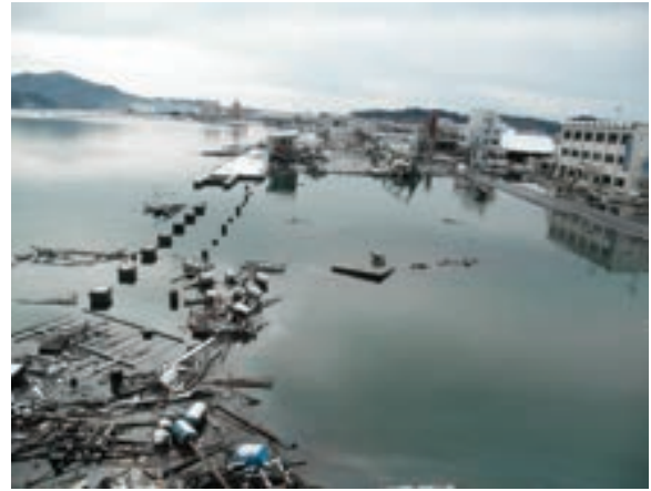
津波により破壊された陸揚げ岸壁と臨港道路 (気仙沼漁港)
