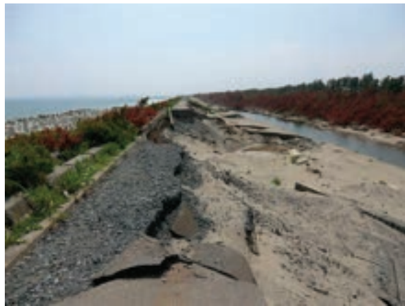
津波により流失した防潮堤と海岸防災林 (東松島市矢本地区)
