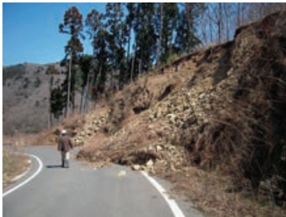
地震により法面が崩壊した林道 (女川京ヶ森線：女川町)
