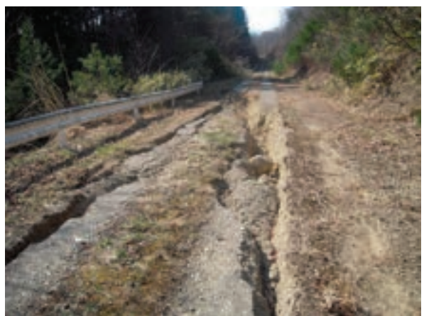
地震により表面に亀裂の走る林道 (羽根坂線：川崎町)
