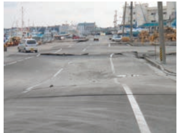
地盤沈下により波打つ臨港道路 (塩釜漁港)
