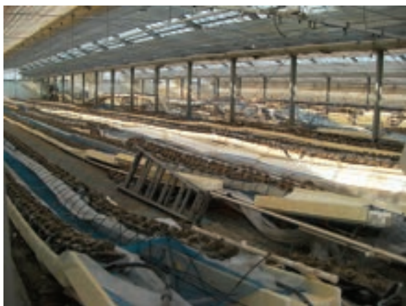
地震により溶液栽培システム等に被害を受けた園芸施設（登米市米山町中津山地区内）
