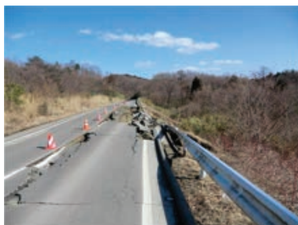
地震により道路半分が崩落した農道 (広域農道仙南地区：蔵王町土浮山地内)
