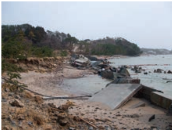
津波により原形をとどめない治山堤防 (長須賀海岸：南三陸町歌津地区)
