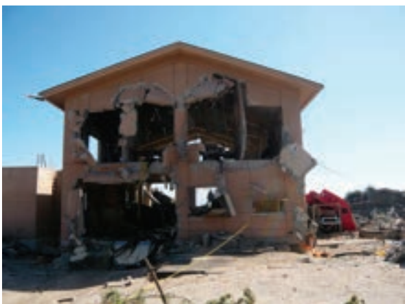
津波の威力を物語る排水機場 (花笠第2排水機場：山元町)
