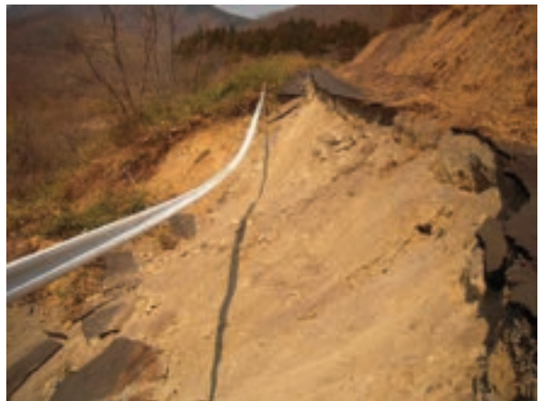
地震により崩落した林道 (高倉線：大和町)
