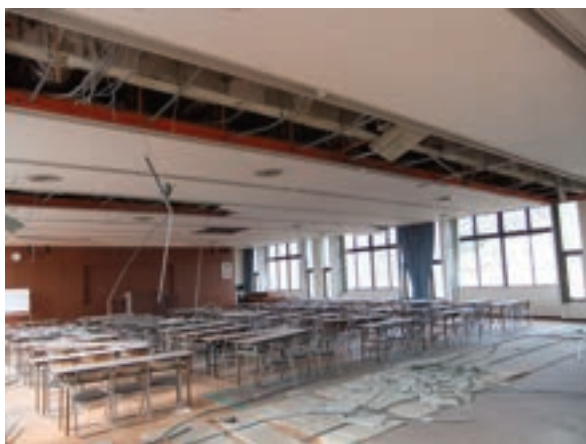
地震により天井が落下した講堂
