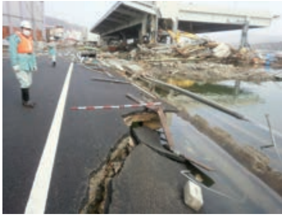
津波によりガレキが押し寄せた魚市場 (気仙沼漁港)
