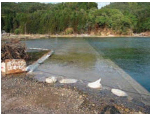
地盤沈下により海水に沈む林道 (日向貝線：気仙沼市)
