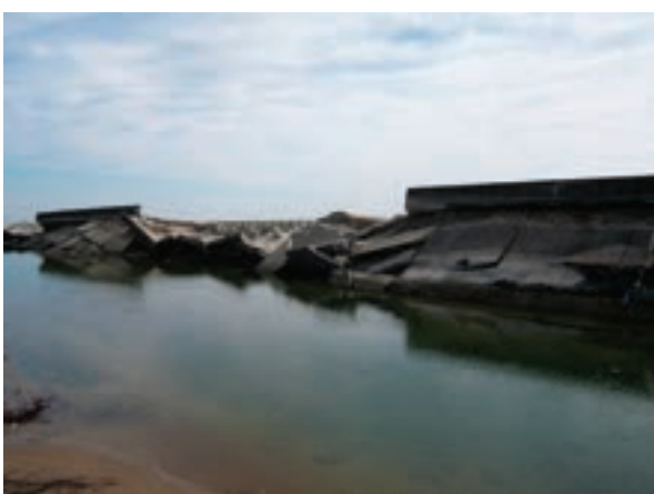
津波により損壊した農地海岸堤防 (亶理町吉田地区)
