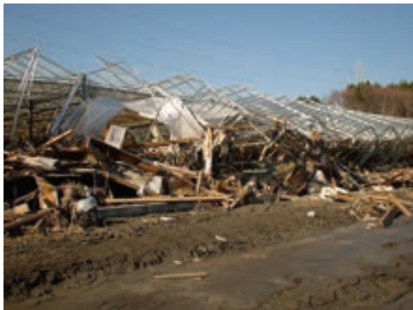
津波により損壊した園芸施設 (七ヶ浜町菖蒲田浜地区)
