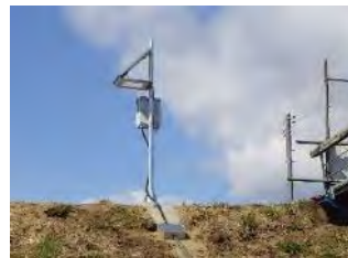
危機管理型水位計 (新川・村田町)
