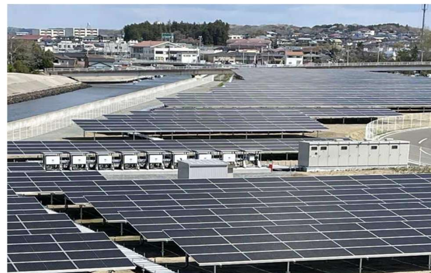
太陽光発電設備
