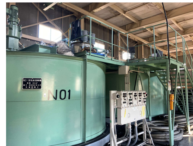
活性炭溶解槽
